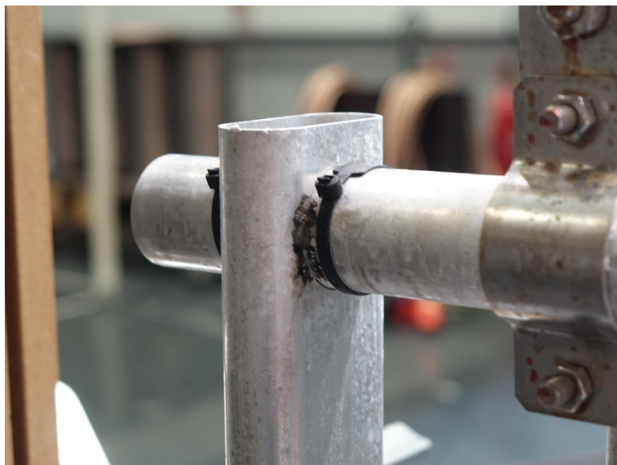
Bild 19: Prüfmuster TS02 S01 nach der Belastung mit 3x 100 kA (10/350 µs) – Überschlagspuren an Pfosten und Handlauf (hi./re./ob.).
